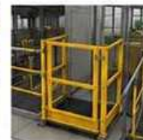
ACCESO A EQUIPOS Y MAQUINARIA
